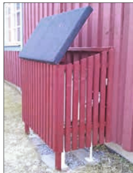
Varmepumpeskjuleren går i ett med den røde husveggen.
