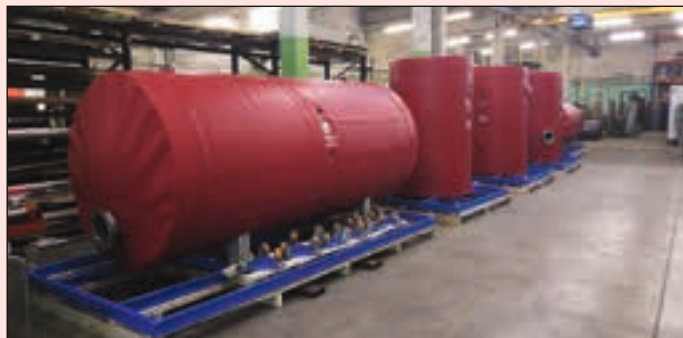
Store akkumuleringstanker sikrer varmegjenvinning og oppvarming av tappevannet i fabrikk.
