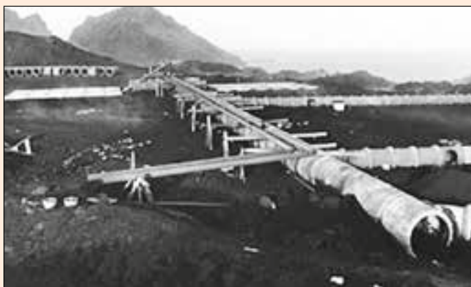
Verdens eneste fjernvarmeanlegg basert på varme fra lava.
