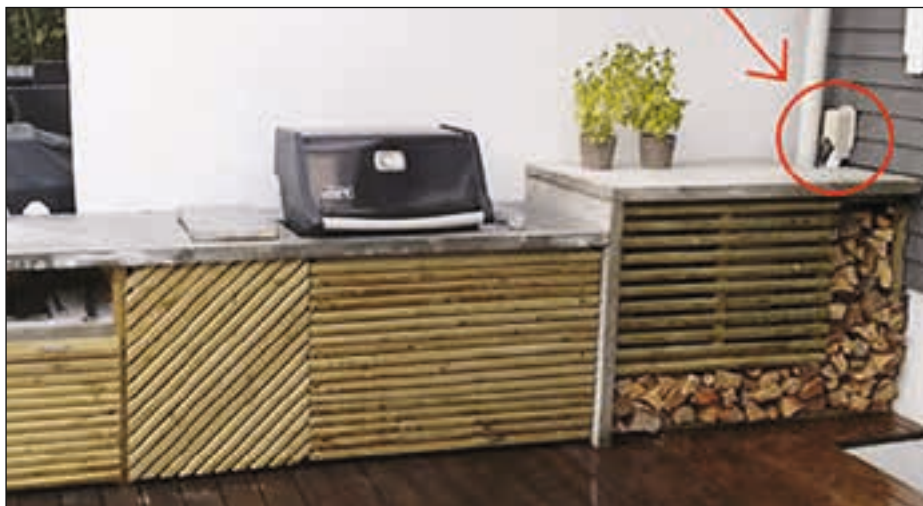
Kun rørgjennomføringen i veggen avslører at det skjuler seg en varmepumpe i det flotte utekjøkkenet.
