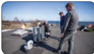
75 Varmepumpe på taget
