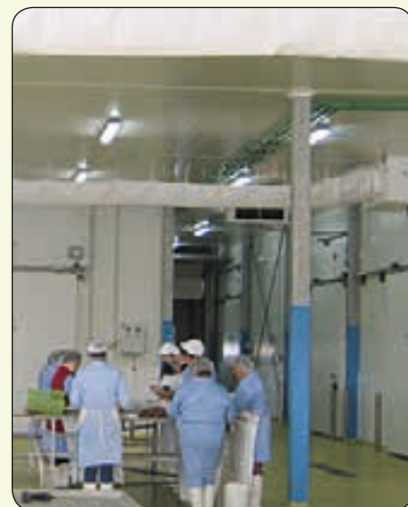
Den kolde luft fra de kubiske Güntner GHN-luftkølere strømmer ind i arbejdslokalerne gennem tekstilslanger.
