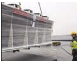
18 Kjøleanlegg med varmepumpe-funksjon
