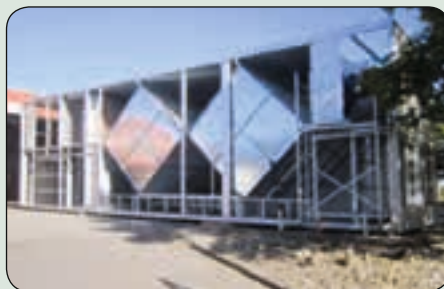
Ét af de to største anlæg på hver 126.000m 3 /h – her under opbygning – har erstattet 6 mindre anlæg og sikret store besparelser.
