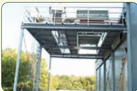
Kondensator opstillet på en stål-konstruktion ved siden af maskinrummet.
