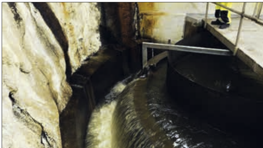
Også i Stavanger er hovedkloakken en egen verden, skjult for de fleste. Men denne kloakken er en utnyttet energikilde som nå skal utnyttes med varmepumper.
